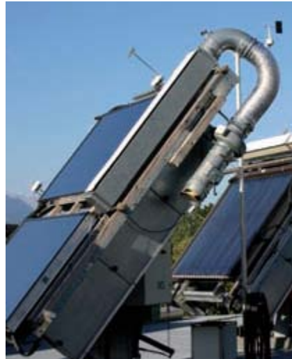
Solarpanel zur Erzeugung von Warmwasser
