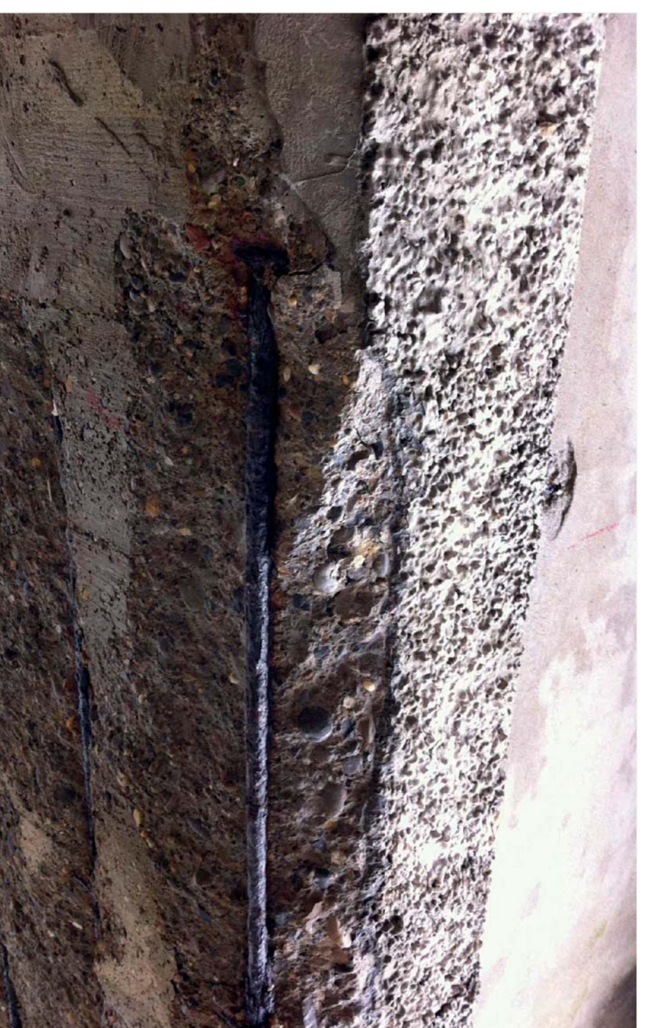
Abb. 2: Betonabplatzung infolge Bewehrungskorrosion an der Bogenunterseite
