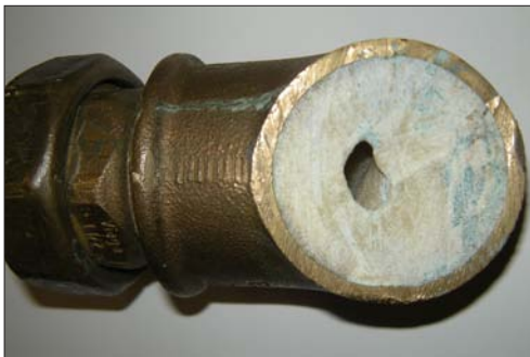
Kalkablagerung in einer Wasserleitung
