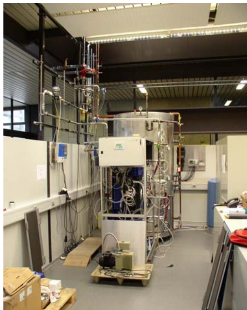
Absorptionskühlmaschine und Speicher
